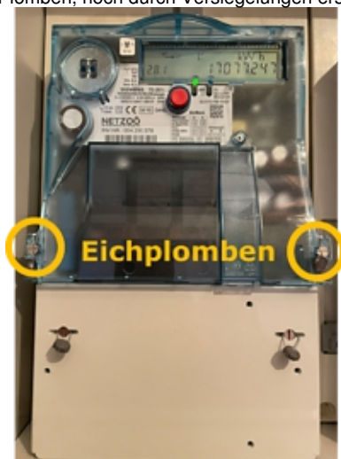
Abb. Eichplombe am Zähler
