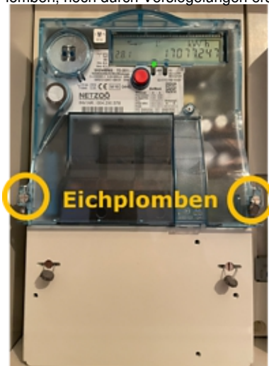
Abb. Eichplombe am Zähler
